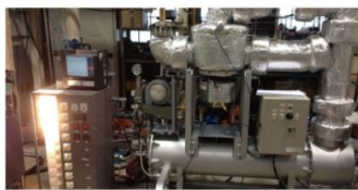
東京ガス、(株)正英製作所 による廃熱発電装置の例
