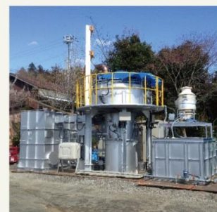
30kW木質チップガス化スターリング 発電システム(乾留ガス化炉との組合せ) (株)プロマテリアル
